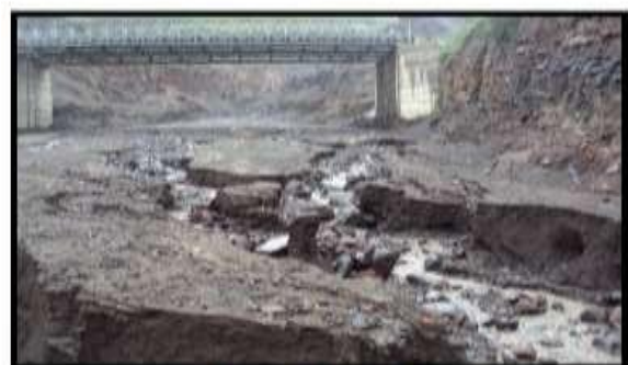
La cercanía de la erosión a las bases del puente
