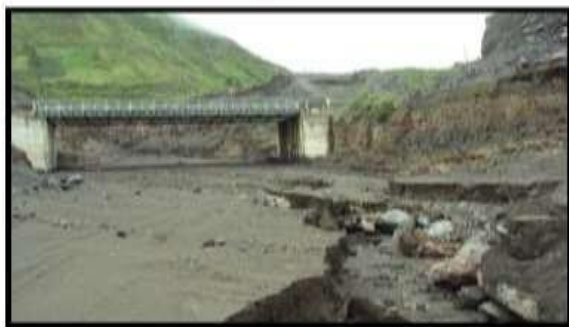
Puentes Bayle Erosión del cauce de la quebrada, lo que ha dado como resultado, la amenaza a que las bases de los puentes se queden sin apoyo estructural
